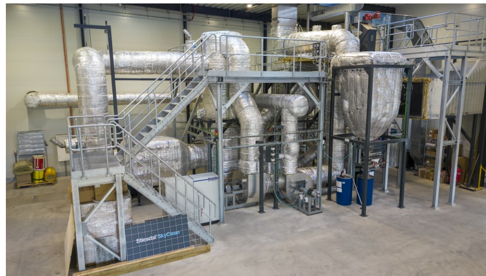
Stiesdal SkyClean (Pyrolyse-anlæg i Skive)
